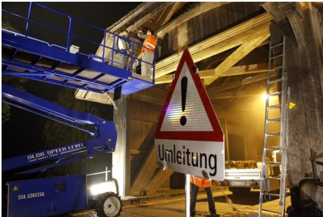
Ein Baufahrzeug war im Sommer in das Brückenportal gerast Quelle: Hanspeter Bärtschi
