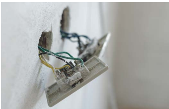
Bei Steckdosen und hinter Elektrotabelleaus trifft man oft auf Asbest.
