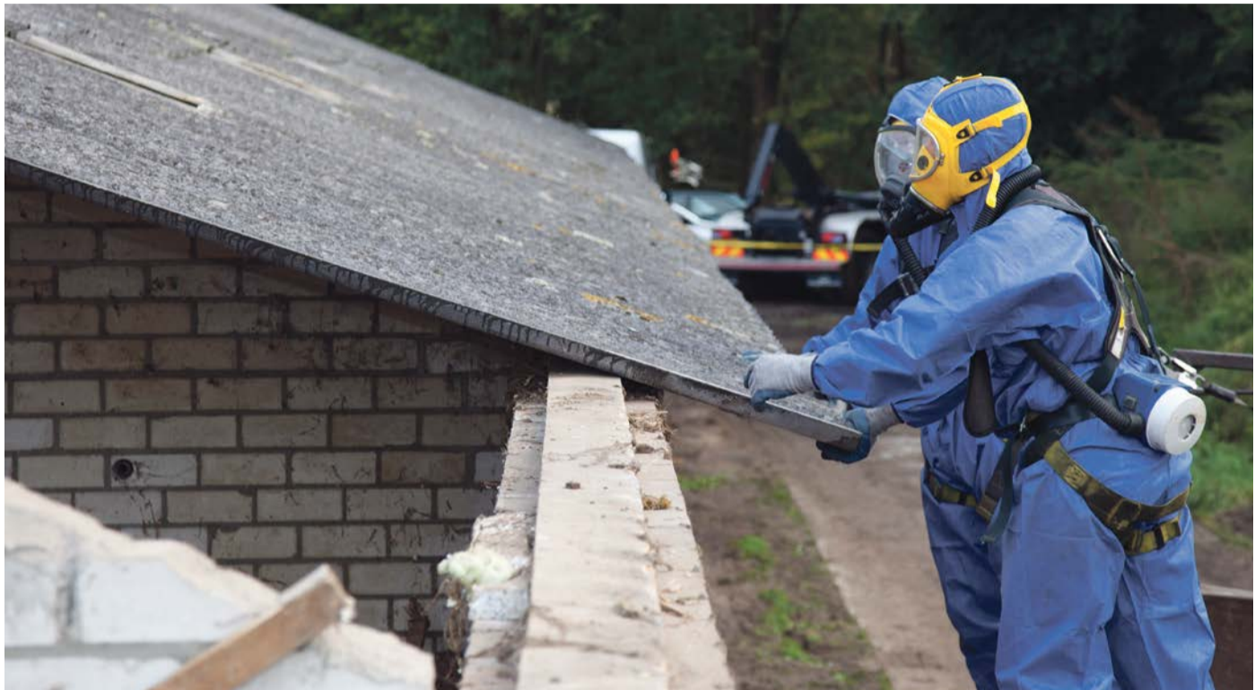
Asbestfasern können in der Lunge Krankheiten wie Asbeststaublung, Lungenkrebs oder Brustfellkrebs verursachen.
